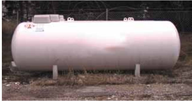
Ortsfester Behälter bis 3 t Fassungsvermögen
